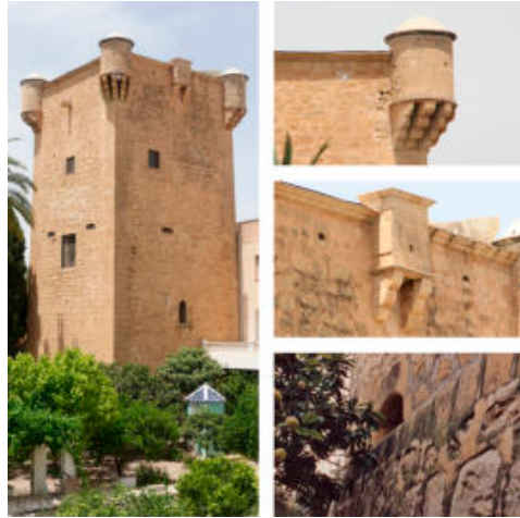
Fig. 5- Torre del Convento de la Verónica-Santa Faz. Vista general de la torre, de una garita, de la ladronera y de una cañonera de la planta baja sobre alambor (Màrius Bevià i Garcia & Jaime Manuel Giner Martínez)
