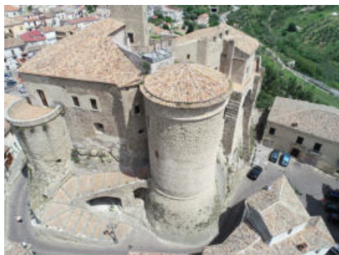
Fig. 5- Castello di Oriolo, fronte roccioso interessato da movimenti del terreno
