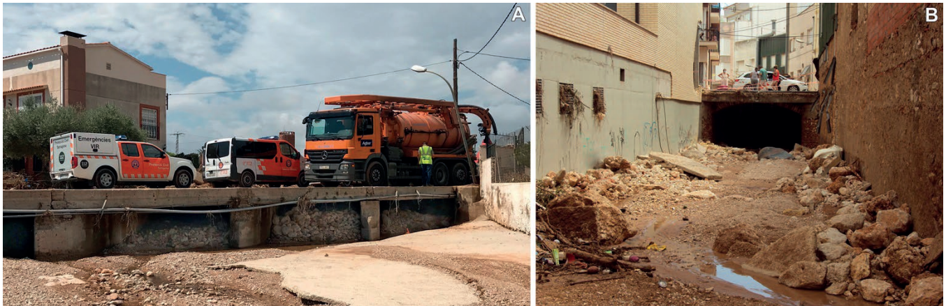
Figura 6 | A) Puente de la calle Trafalgar (punto 2) totalmente obturado por los materiales transportados. Vista desde aguas abajo hacia aguas arriba. B) Túnel de entrada al cubrimiento del torrente bajo las calles Isaac Peral y del Barranc desde aguas arriba (punto 3). Se observan las dimensiones de los fragmentos de los muros de piedra y paredes arrancados por las aguas y acumulados en el cauce.
