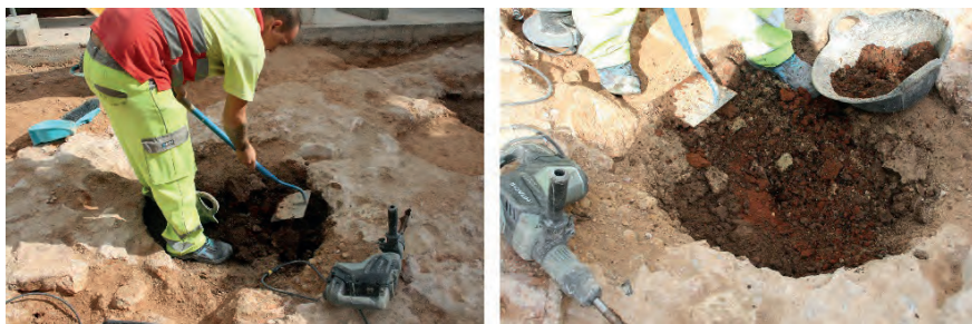
Figura 14. Imatges del procés d'excavació d'un dels escocells en què s'aprecia la terra del seu rebliment.
