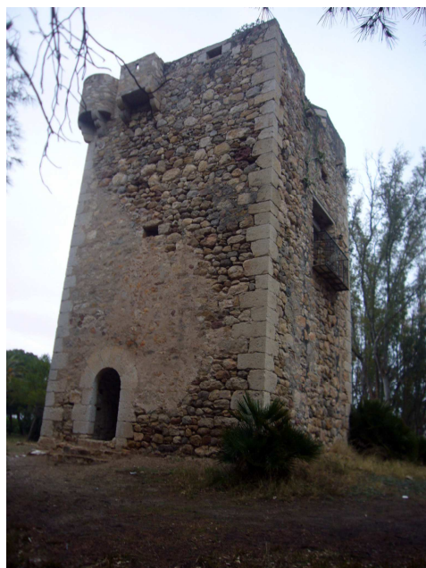
Fig. 1. Ángulo Sur antes de la intervención. Se observa la estructura del balcón suprimido por extemporáneo, añadido en la década de 1960 (Autor, 2016).
