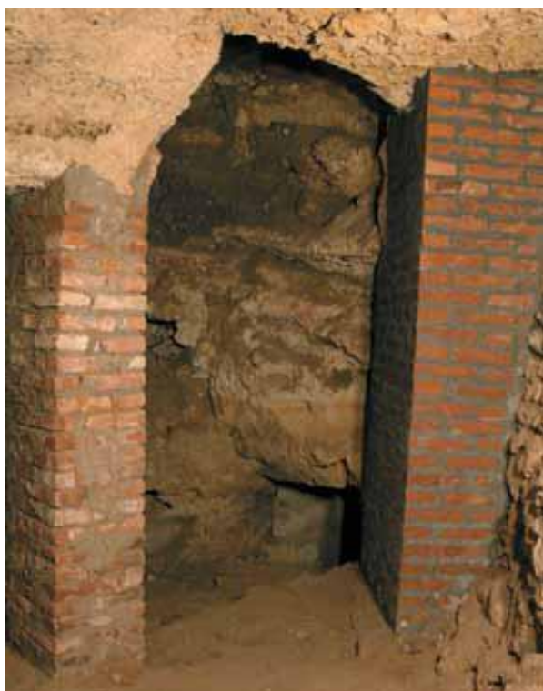
Figura 4 – Pilastrini in laterizi pressati che puntellano i soffitti della regione C
