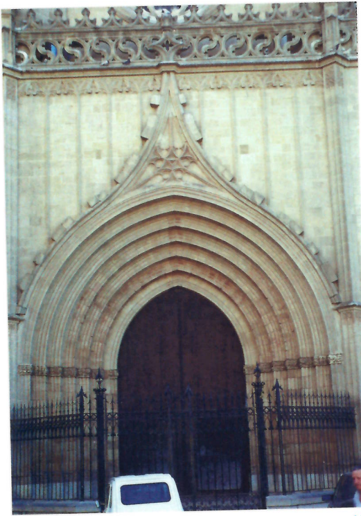
11. Portada Oeste. Estado anterior a la restauración
